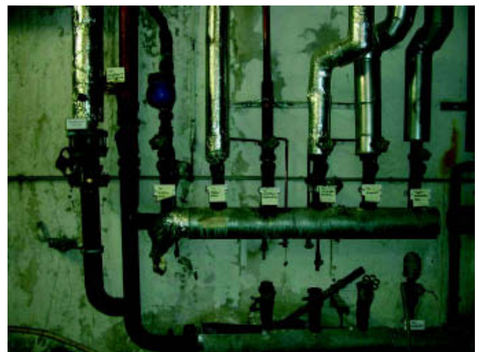
■ Trinkwasserverteiler: Stagnation und fehlende Dämmung.
