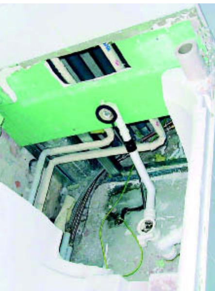
■ Schlauchleitung, außer als Armaturenanschluss nicht zulässig.
