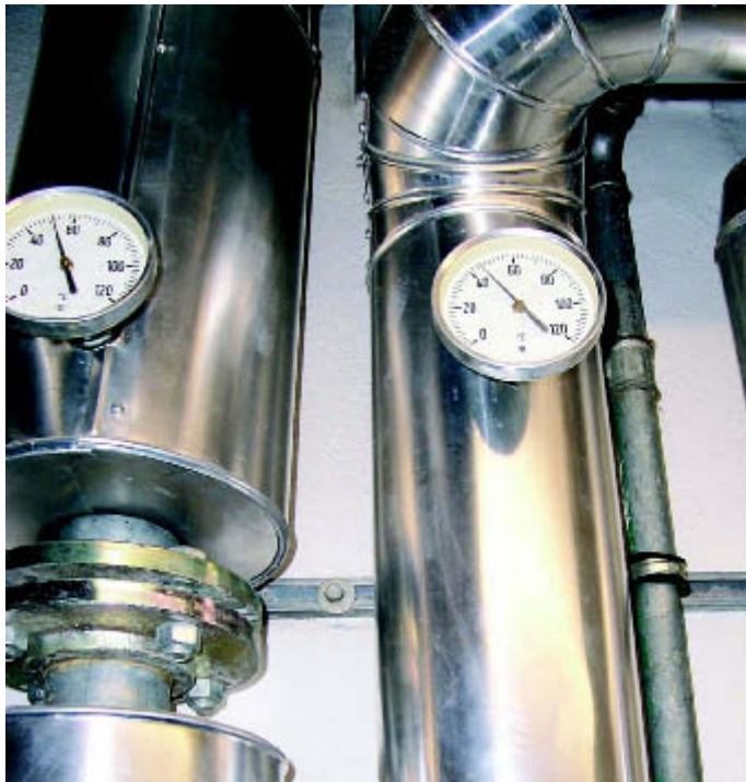
■ Warmwasser- und Zirkulationstemperaturen im unzulässigen Bereich.
